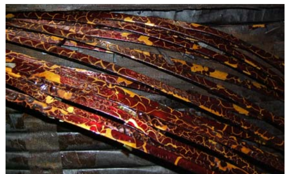
Bild 3 Leiter mit aufgeplatzter Lackisolierung der Kupferleiter der US-Wicklung des 110-MVA-Maschinentransformators
